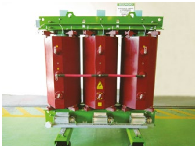
Transformador Encapsulado elevador YNd11, con ventilación forzada
